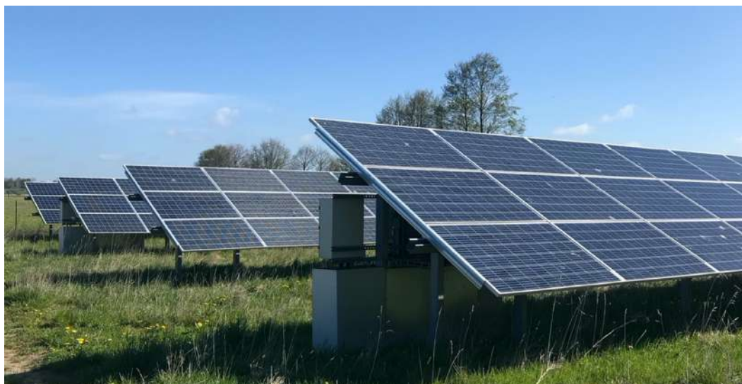
Figur 3.3: Växelriktare förankrade i markställningen. Bild från Svea Solars solpark i Sjöbo.
