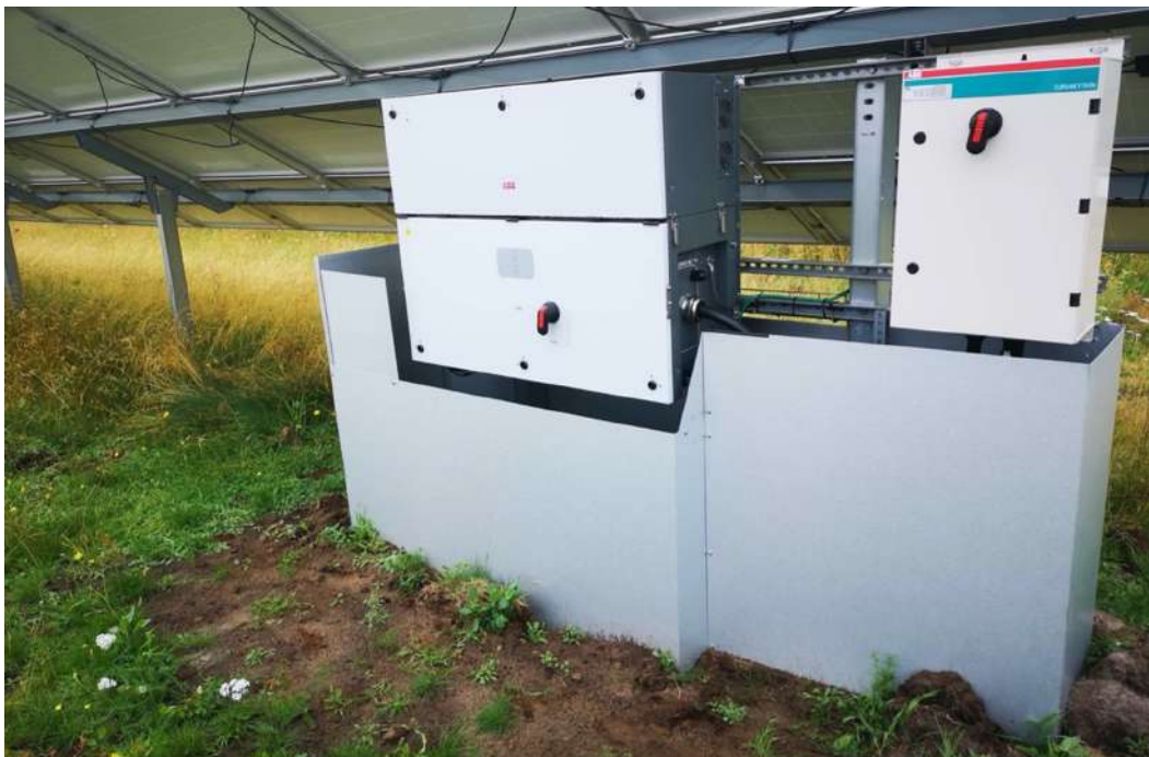
Figur 6.1: Gnagskydd runt växelriktare och kablar.
