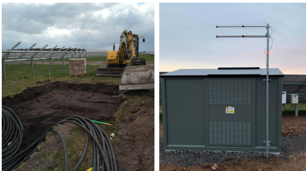
Figur 4.5: Vänster: markförberedelser för transformatorstation. Höger: transformatorstation. (©Svea Solar)
